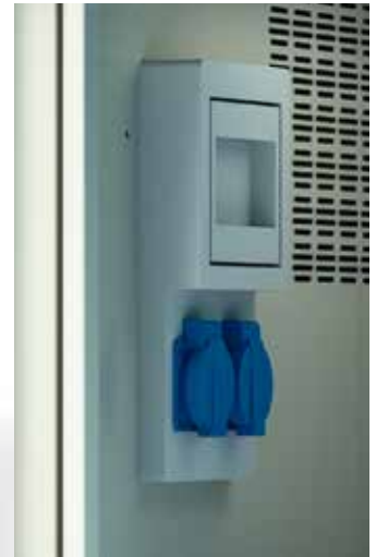
Steckdose 230V/16A mit Deckel, FI/LS Schalter je Fach
